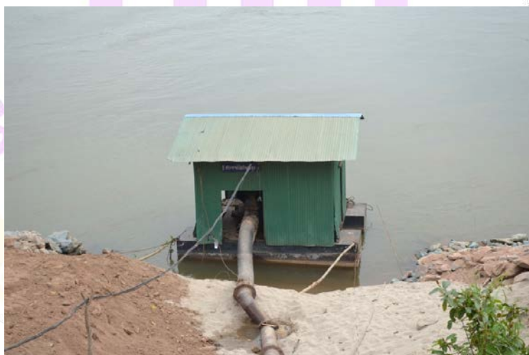
รูปที่ 1 สถานีสูบน้ำด้วยไฟฟ้า
